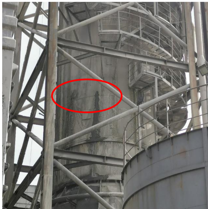
图16 脱硫塔腐蚀泄露
